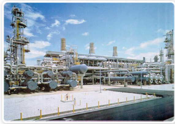
The Arun LNG facility
